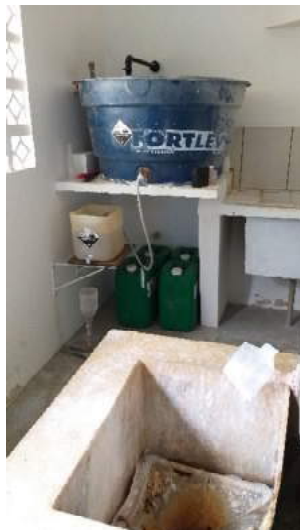
Figura 26: Sistema de dosagem (CASAN, 2019)
