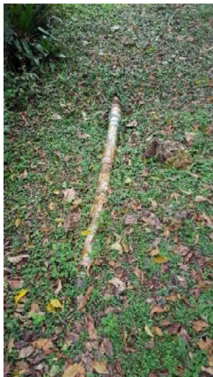
Figura 16: Adutora de Água Bruta Rio Santa Cruz da Figueira (CASAN, 2019)
