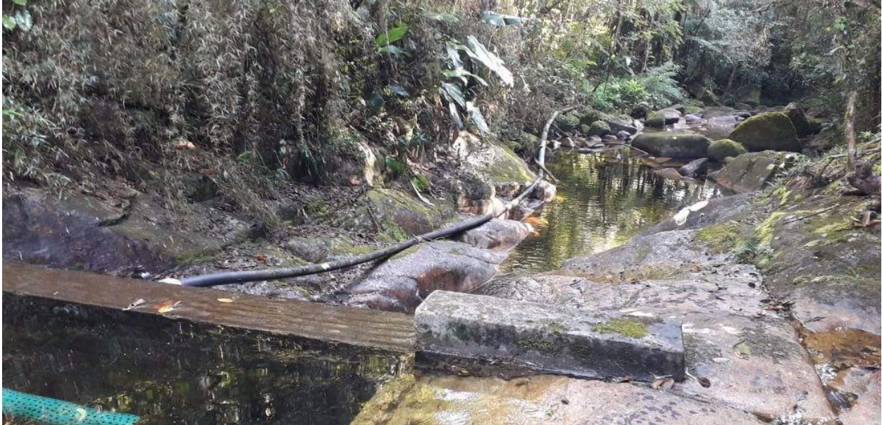
Figura 15: Adutora de Água Bruta Rio Santa Cruz da Figueira (CASAN, 2019)
