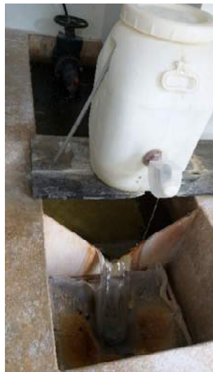
Figura 25: Sistema de dosagem (CASAN, 2019)
