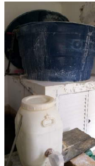
Figura 27: Sistema de dosagem (CASAN, 2019)
