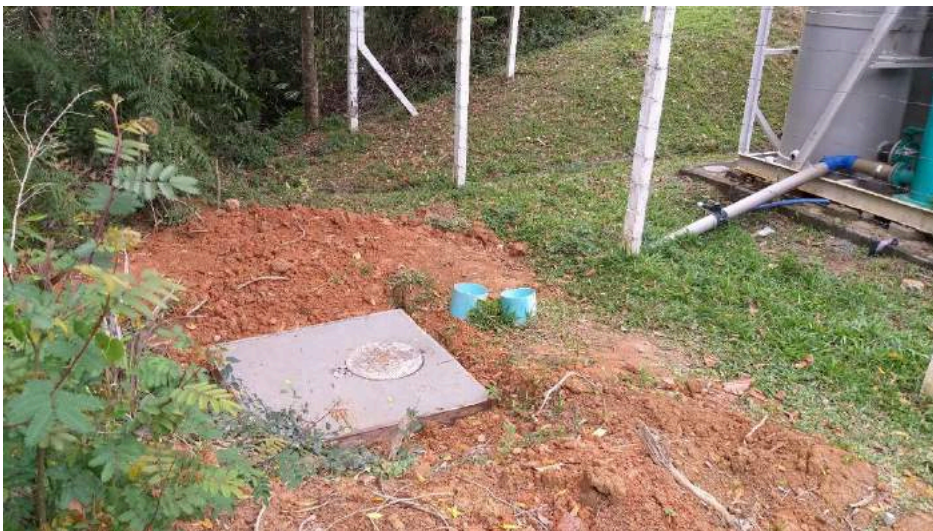
Figura 23: Macromedidor na entrada da ETA (CASAN, 2019)
